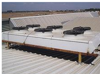
Fig. 4. Condensador sistema de refrigeración industrial con R22.
