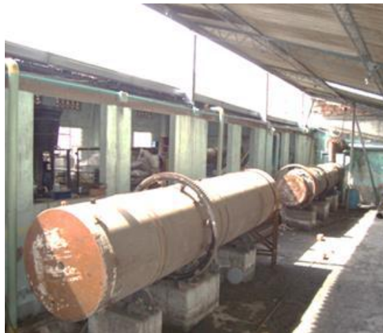
Figura. 2 Fotografía de la planta; horno de activación en primer plano, y carbonización al fondo.
