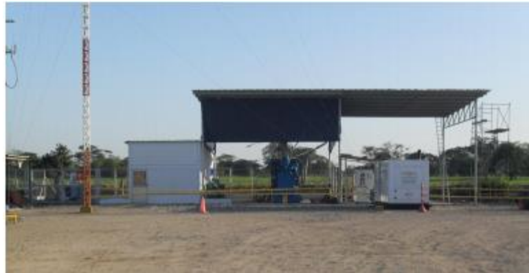
Figura 1. Centro de generación.
