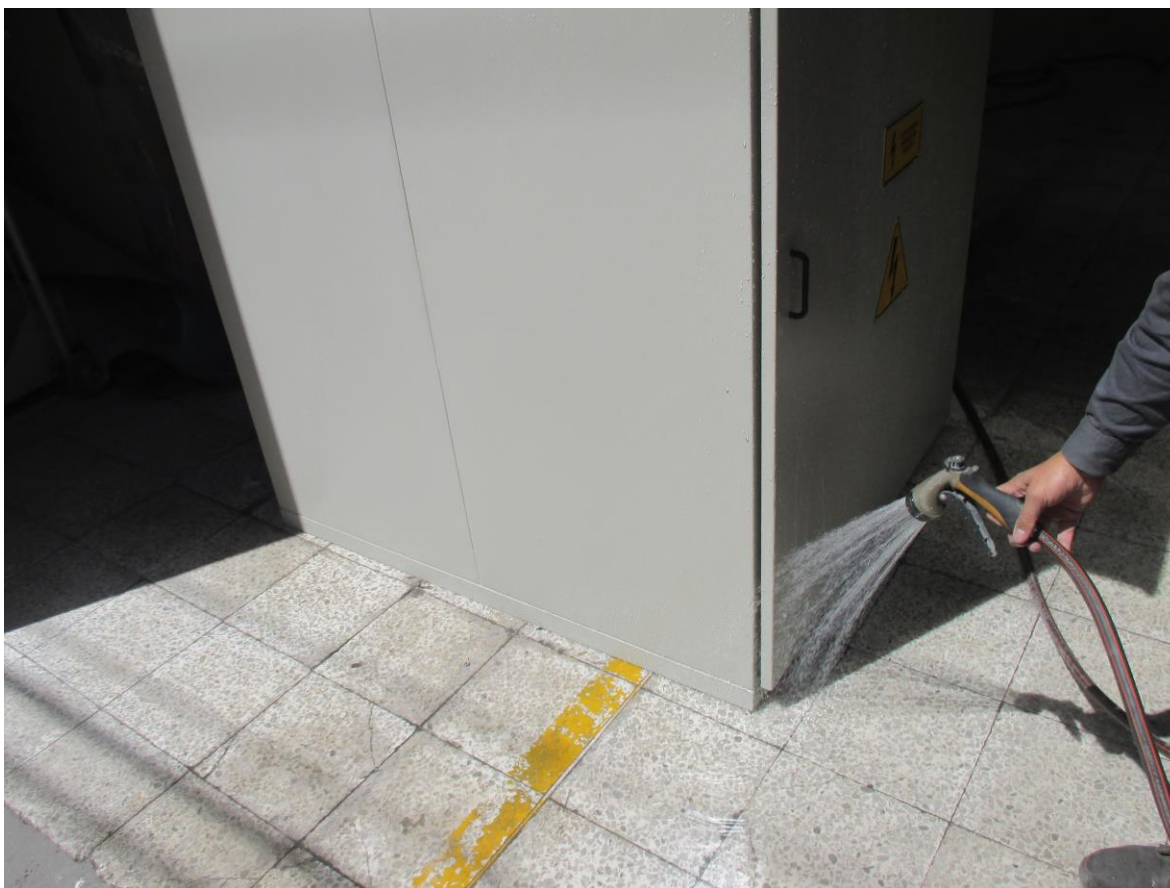
Figura n°1: verificación grado de protección tipo 3R 2
