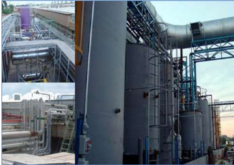
Fig.4 Líneas de tubería metálica.
