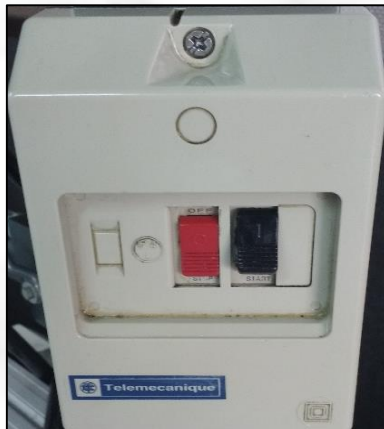
Imagen 12 Panel de encendido de la bomba (interruptor negro encendido, interruptor rojo apagado).
